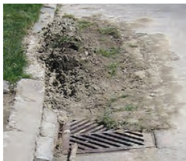
Une grille de bouche d'égout non obstruée par des débris est mieux en mesure d'évacuer les eaux pluviales et peut réduire les risques d'inondation par ruissellement.
